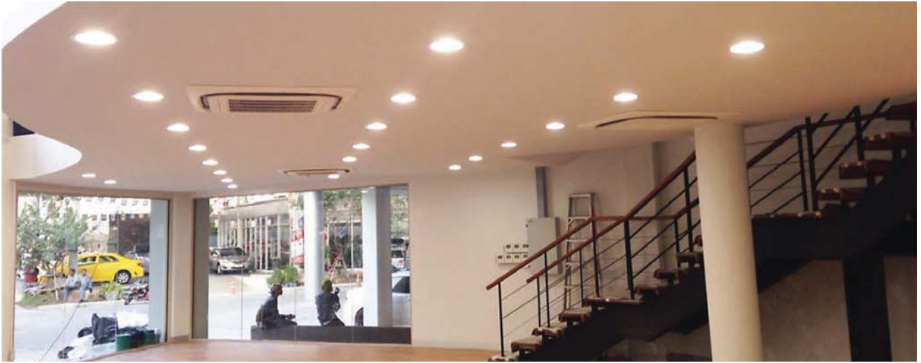
RECESS DOWNLIGHT LED (FIXED) / โคมไฟดาวน์ไลท์แอลอีดีฝังฝ้า ชนิดปรับมุมไม่ได้
